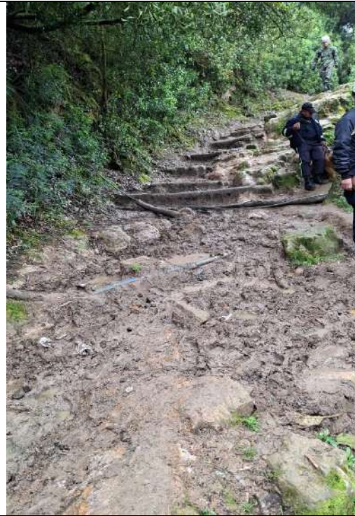
Imagen 7. Mal estado del camino alterno empeorado por las lluvias.
