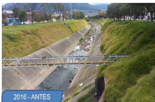
Foto 7. Canal Córdoba 2016 - antes
