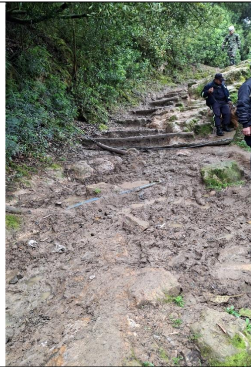
Imagen 7. Mal estado del camino alterno empeorado por las lluvias.
